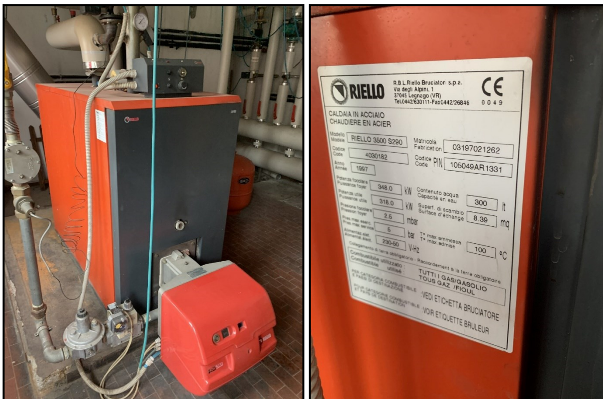
Immagine generatore di calore a basemento esistente a servizio del sistema di riscaldamento
