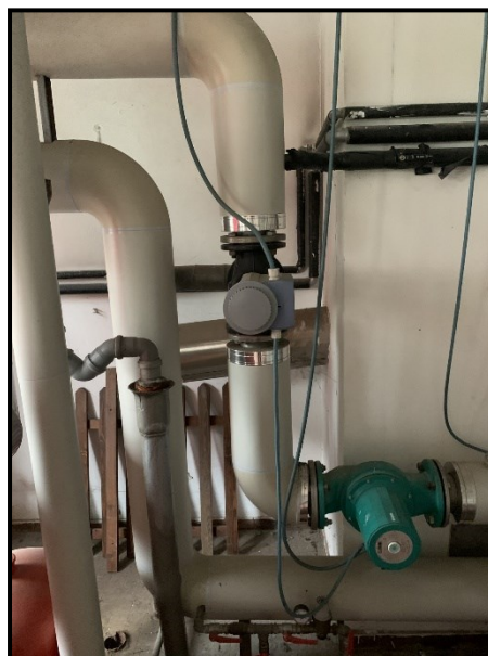
Immagine elettropompa di circolazione primaria con valvola miscelatrice per la regolazione di temperatura climatica
