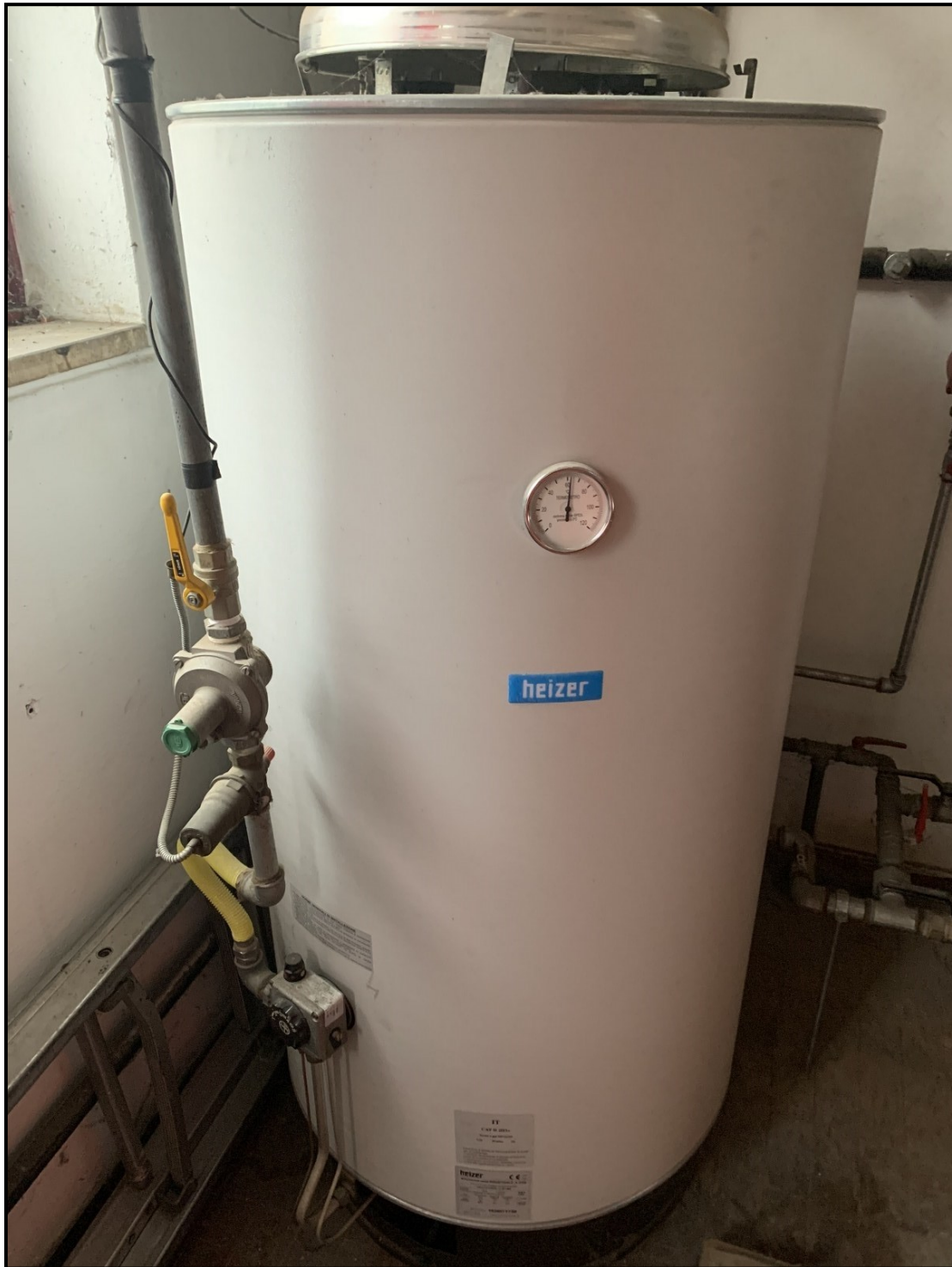
Immagine bollitore acqua sanitaria a gas metano
